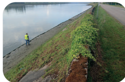
Végétation indésirable sur la murette
