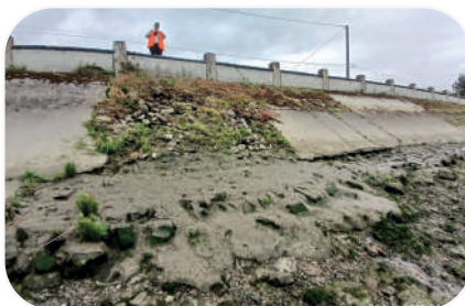
Désordre ponctuel (cavité)
